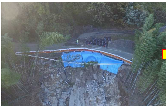
写真⑤:被災状況(令和元年11月8日撮影)
