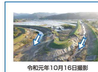
被災直後の決壊状況
