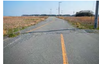
地震・津波により舗装のズレが生じた町道両竹・請戸線
