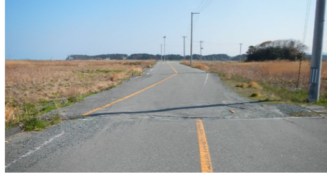
地震・津波により舗装のズレが生じた「町道両竹・請戸線」
