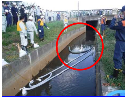
オイルフェンス設置の悪い例 (U字型の展開)
