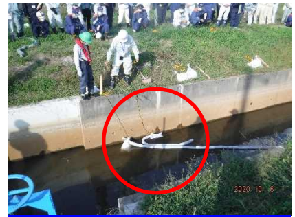
オイルフェンス端部の処理方法 (土のう、2重オイルフェンス)
