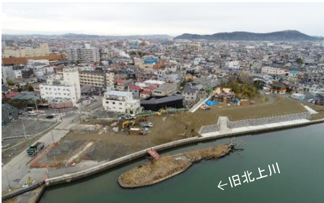
① 右岸住吉地区の堤防復旧状況
