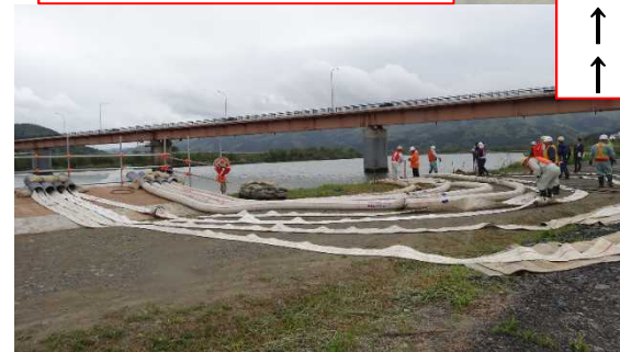
北上川下流河川事務所 排水ポンプ車配備状況
