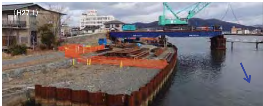
・川前護岸の施工が完了 ・(宮城県)新内海橋の橋脚を施工中
