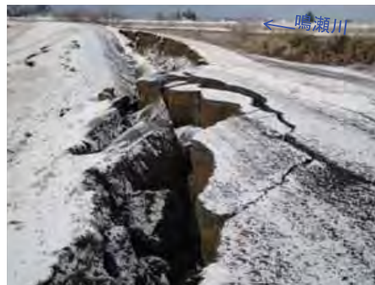
地震により天端沈下と縦断クラック発生 (鳴瀬川左岸11.4k付近 美里町二郷砂山地先)
