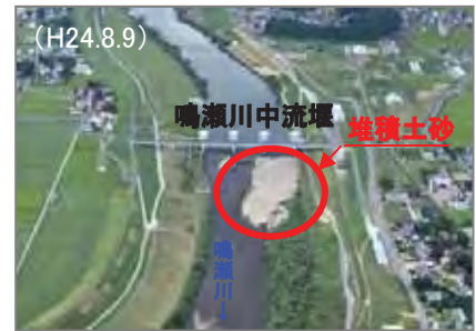
鳴瀬川中流堰の堆積土砂状況
