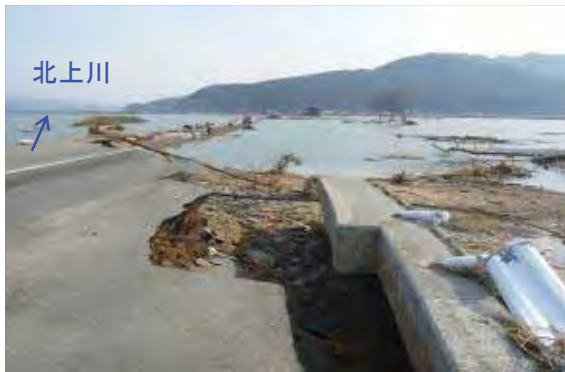
津波により堤防決壊 (北上川右岸4.0k付近 石巻市釜谷地先)
