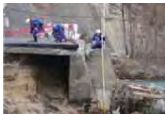
道路被災状況の調査
