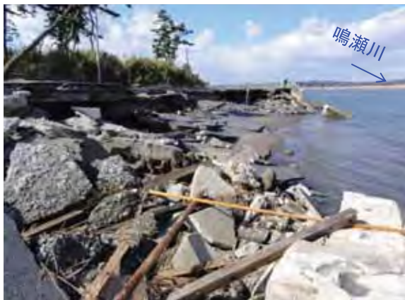
津波により特殊堤が流出 (鳴瀬川右岸0.0k付近 東松島市野蒜地先)
