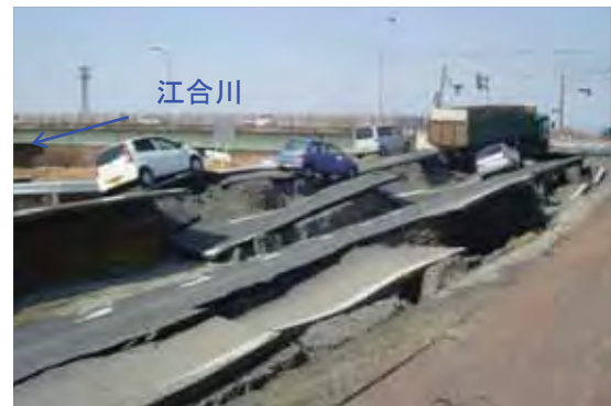
地震により堤防崩壊 (江合川左岸27.6k付近 大崎市古川淵尻地先)
