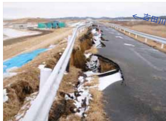
地震により縦断クラック発生 (吉田川左岸14.4k付近 大崎市鹿島台大迫地先)
