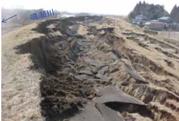
地震により堤体が崩落 (鳴瀬川左岸30.3k付近 大崎市古川下中目地先)
