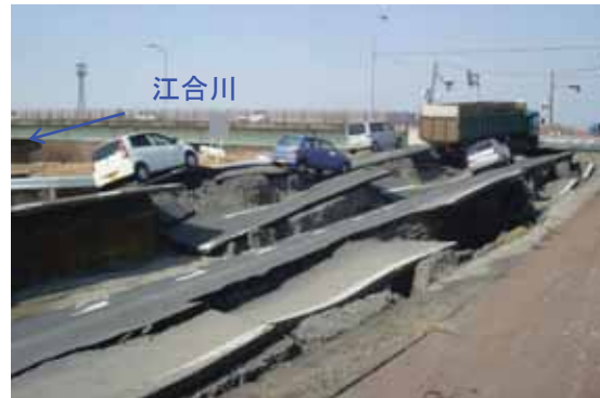
地震により堤防崩壊 (江合川左岸27.6k付近 大崎市古川瀧尻地先)
