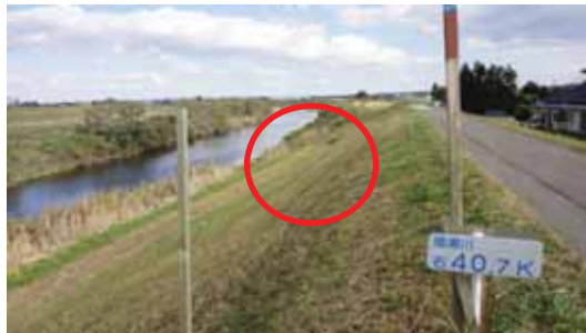
堤防天端から見た法面状況 (法面の変状が分かり難い)
