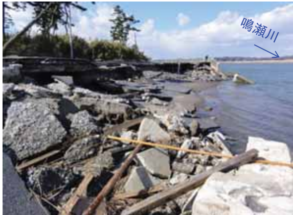
津波により特殊堤が流出 (鳴瀬川右岸0.0k付近 東松島市野蒜地先)
