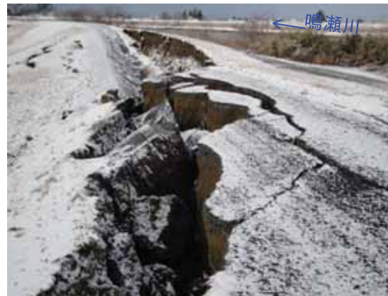
地震により天端沈下と縦断クラック発生 (鳴瀬川左岸11.4k付近 美里町二郷砂山地先)
