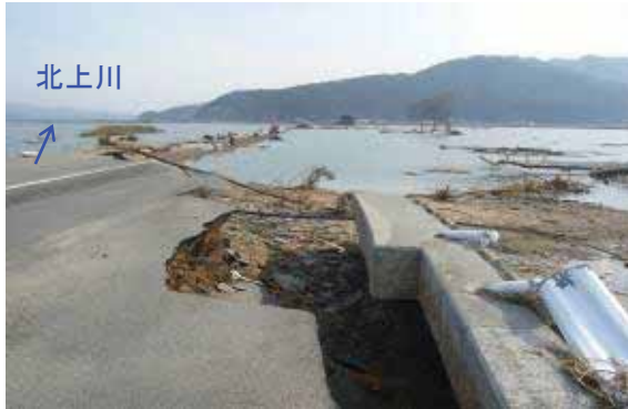
津波により堤防決壊 (北上川右岸4.0k付近 石巻市釜谷地先)
