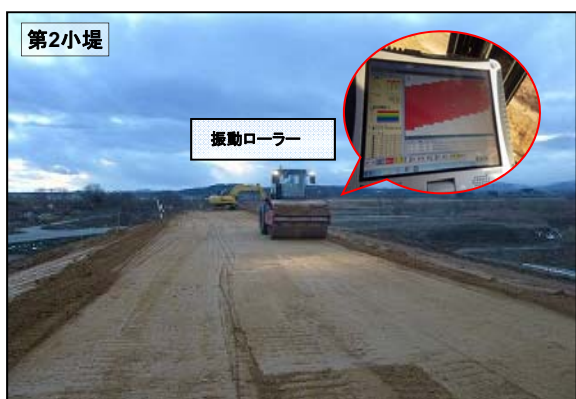
【GPS転圧管理システム】
