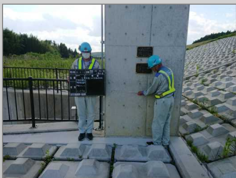
被害想定：門柱クラック
