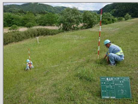
被害想定：堤防の法面クラック
