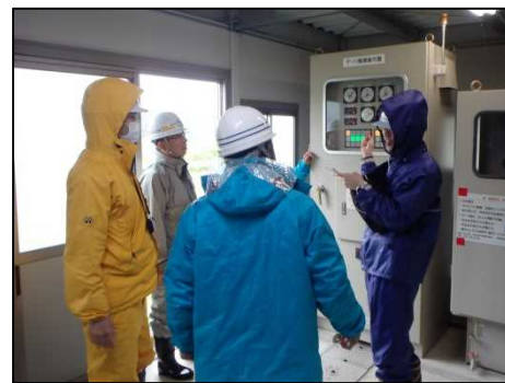
操作盤の確認
