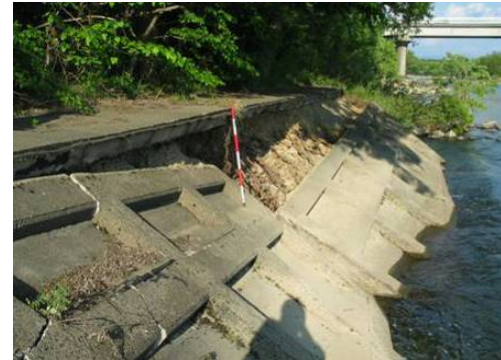
洗掘による護岸崩落状況
