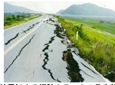
地震による堤防クラックの発生状況 (S53宮城県沖地震)
