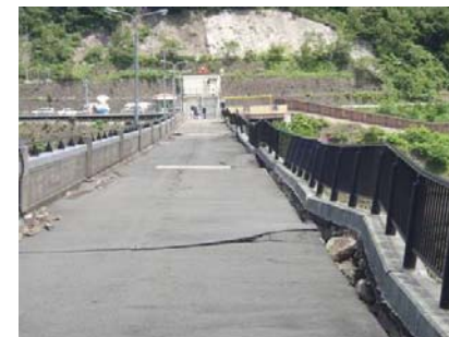
岩手・宮城内陸地震（平成20年） （石淵ダムの天端にクラックが発生）
