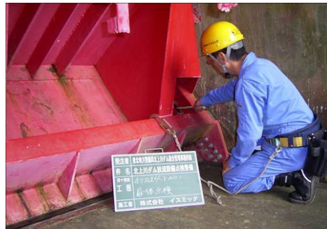
放流設備点検
