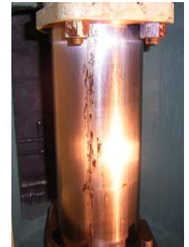
シリンダロッドの発錆状況 （田瀬ダムコンジットゲート）
