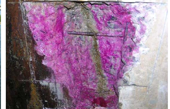
樋管内部の鉄筋腐食状況
