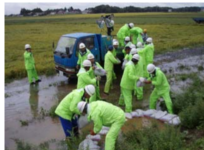
漏水発生箇所の水防活動状況 (平成19年9月洪水:奥州市吹張地区)
