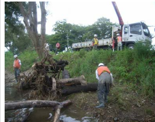
流木処理の状況
