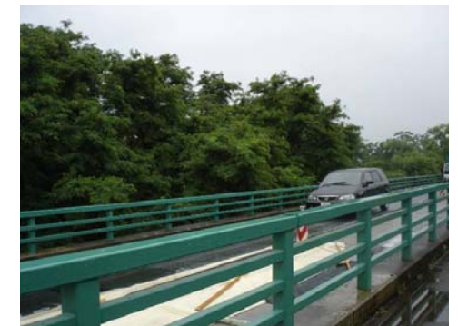
橋梁を覆うほど生長した河道内樹木状況
