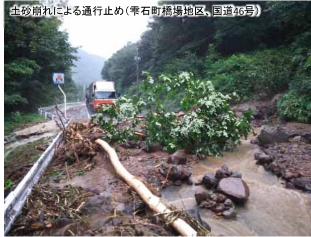
土砂崩れによる通行止め(雫石町橋場地区、国道46号)
