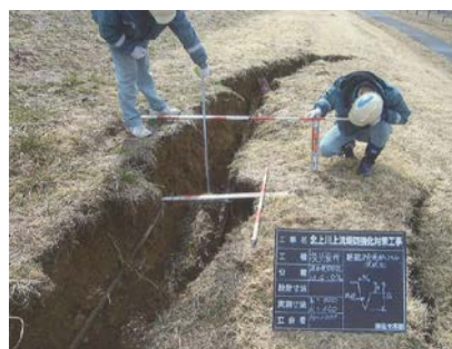
[周囲堤被災状況]川裏法面すべり崩壊
