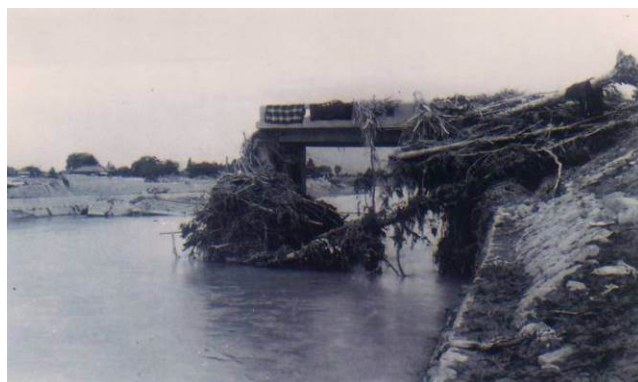
洪水によって落橋した上ノ橋（磐井川）
