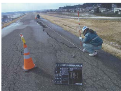
[周囲堤被災状況]天端縦断クラック
