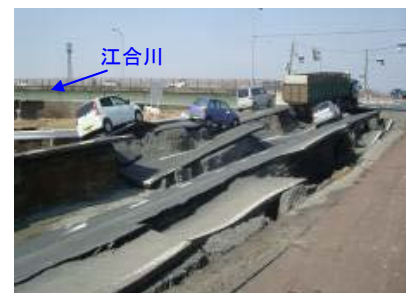
江合川左岸27.6k付近 (大崎市古川瀨尻地先) ※地震により縦断クラック発生
