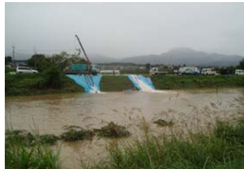
紫波町高水寺地区での内水排除状況 (平成 19 年 9 月洪水)
