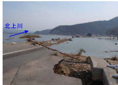
北上川右岸4.0k付近(石巻市針岡地先) ※津波により堤防が流出
