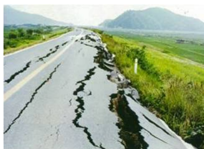
地震による堤防クラックの発生状況 (S53宮城県沖地震)
