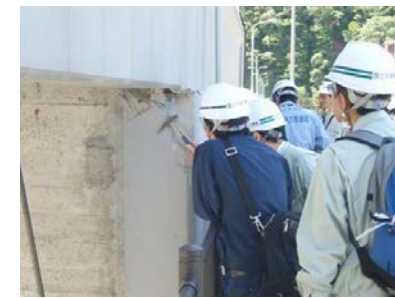
被災したダム堤体の調査 (H20岩手・宮城内陸地震)
