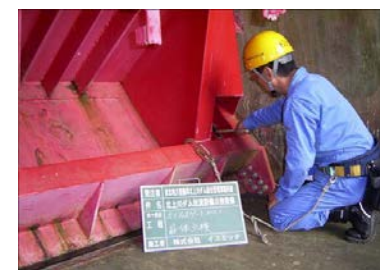
放流設備点検
