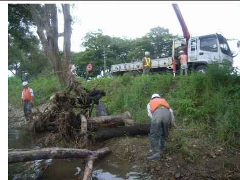
流木処理の状況
