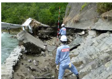
▲ 被災状況調査
