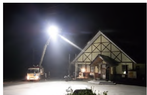
▲ 避難所への照明車設置
