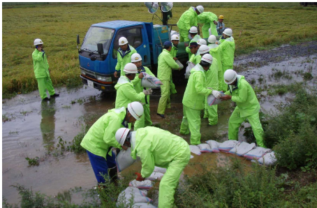
漏水発生箇所の水防活動状況 (平成19年9月洪水・奥州市姉体地区)
