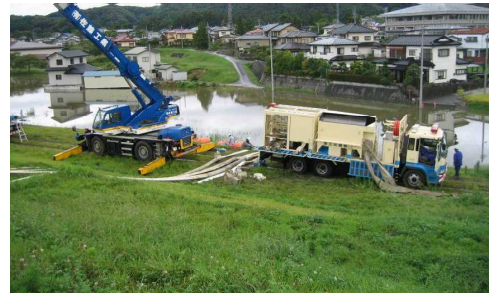
排水ポンプ車による排水活動状況 (平成19年9月洪水・平泉町倉町地区)
