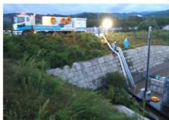
排水ポンプ車稼働状況(宮古市)
