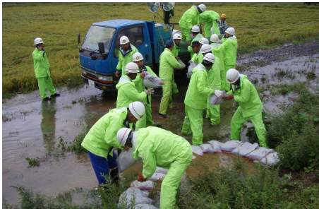
漏水発生箇所の水防活動状況
