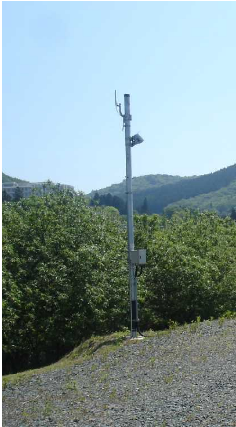
水害リスクが高い箇所でリアルタイムに水位を把握する簡易水位計
