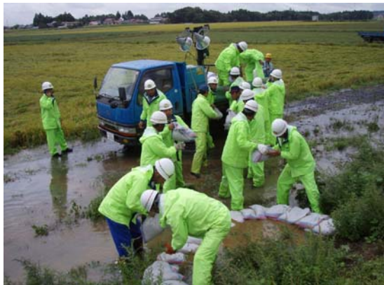
漏水発生箇所の水防活動状況 (平成19年9月洪水・奥州市姉体地区)
