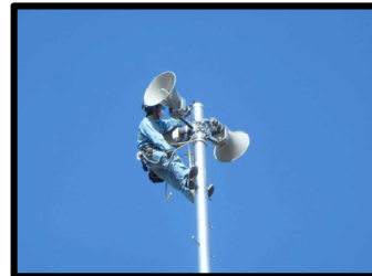
防災無線のデジタル化
