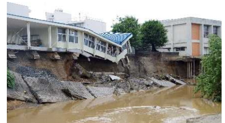
河岸侵食に伴う家屋倒壊等
