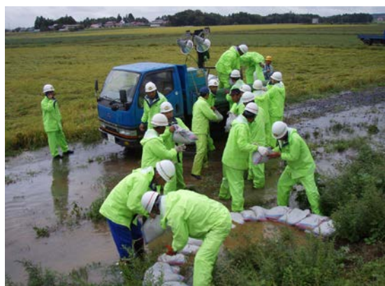
漏水発生箇所の水防活動状況 (平成19年9月洪水・奥州市姉体地区)
