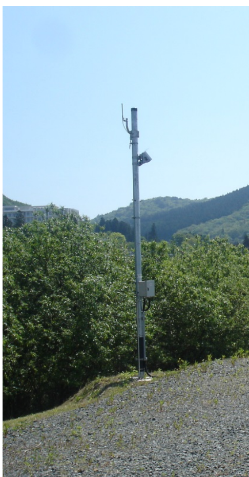
水害リスクが高い箇所でリアルタイムに水位を把握する簡易水位計
