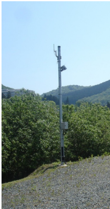
水害リスクが高い箇所リアルタイムに水位を把握する簡易水位計
