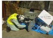
Ku-SAT設置状況(宮古市)
