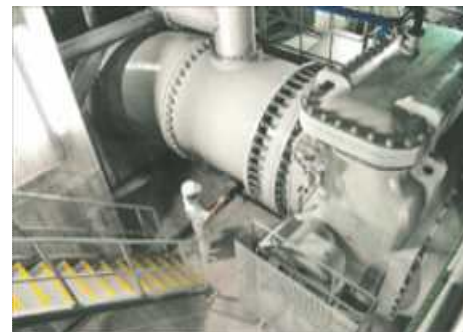
雨水ポンプの整備
