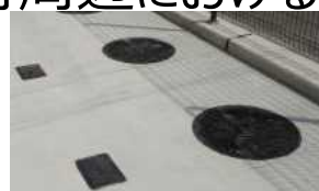
マンホールトイレ
