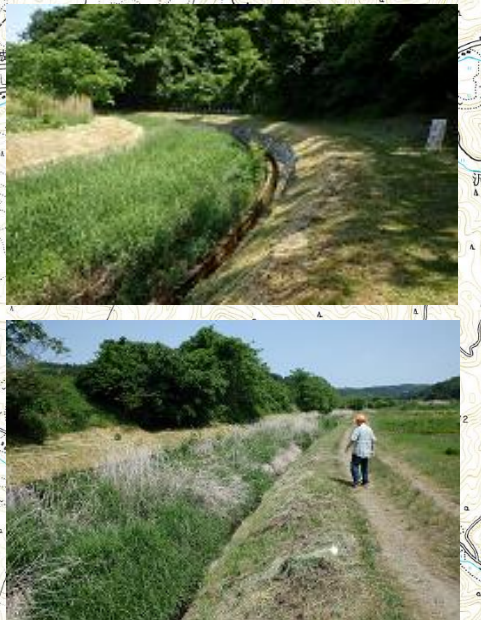
土砂堆積状況
