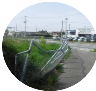
↑ 立入防止柵の傾倒
