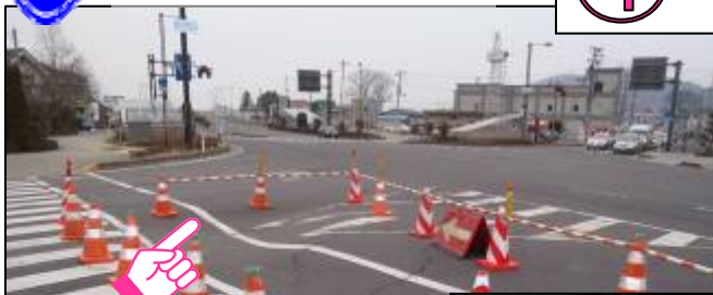
クラック & 陥没
