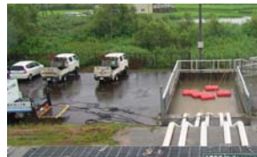
水穴樋管の排水ポンプ稼働の様子
