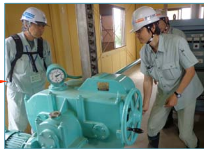
◀ 樋門開閉操作
