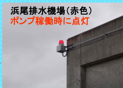
回転灯の設置
