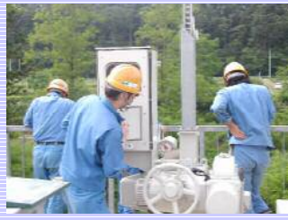
＜開閉装置の点検＞
