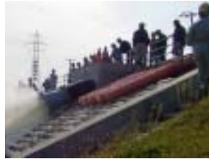
ポンプ排水状況
