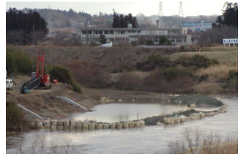
1月22日16時 仮締め切り被災状況 川原地区工事(郡山市)
