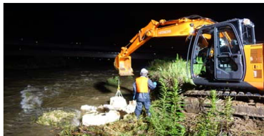
▲大雨により川が増水した荒川。濁流が迫る危険な状況でしたが、迅速に応急復旧の工事を行いました。
