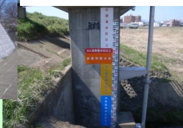
南町排水機場（柳原樋管）
