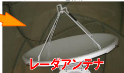
伊達局として、伏黒出張所管内の東根川救急内水排水施設にレーダアンテナを設置
