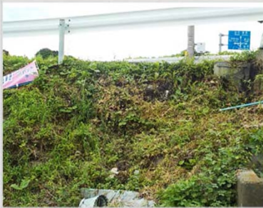
法面の崩れ発生
