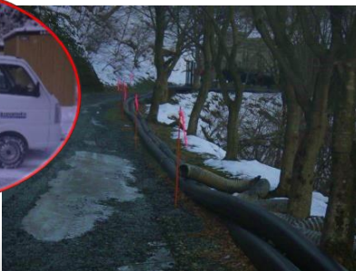
▲除雪時でもバイナリー発電施設の温泉水送水管が分かるよう注意喚起のための目印を設置しています
