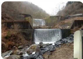
①東鴉川砂防堰堤
