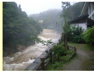
降雨後の濁流 荒川第2堰堤
