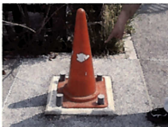
突起物に歩行者が踏く可能性がありました ので、カラーコーンで突起物を保護しました。 (ダム堤体周辺地域・三春町)
