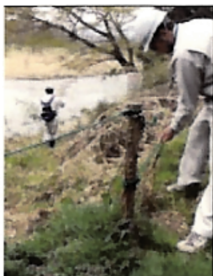
立入制限区域のロープが切れていたのを、 ロープを再度設置しました。 (乙字水辺の小栗校・玉川村)
