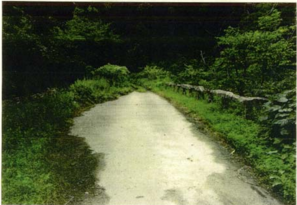
福島側⑦橋干が崩れつつある鳥川橋
