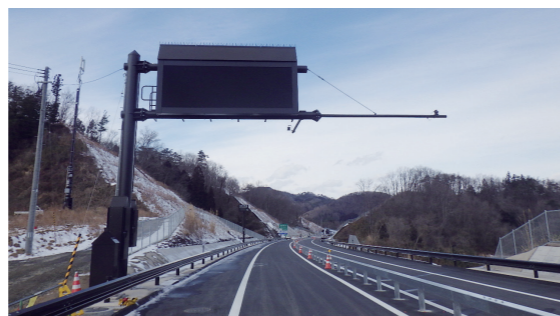
【道路情報表示設備への共架】
