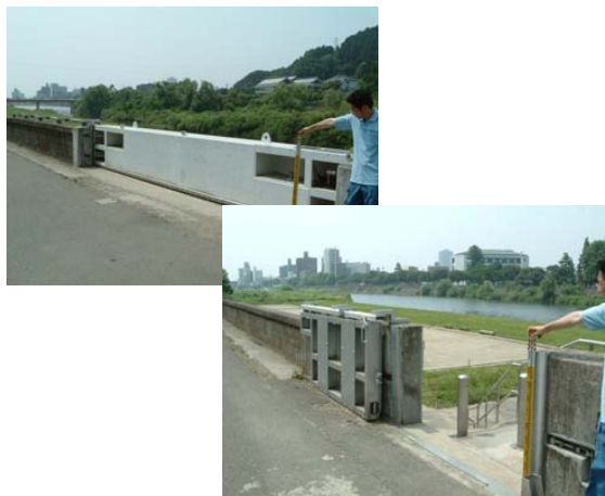
陸閘(ゲート)の設置事例
