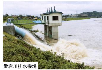
愛宕川排水機場
