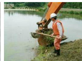
流木処理の状況
