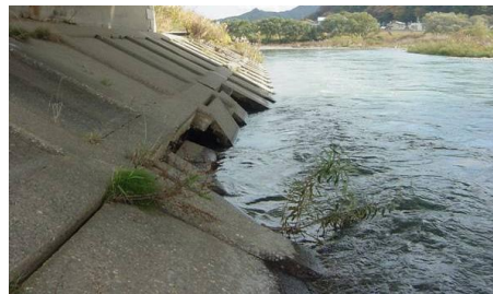
支川荒川 信夫橋護岸の崩壊の状況
