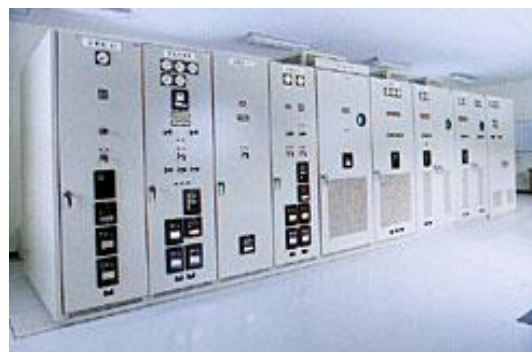
七ヶ宿ダム 受変電設備
