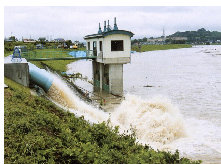
あたご 須賀川排水機場(郡山市)
