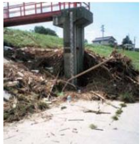
塵芥の堆積状況
