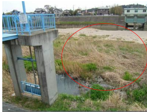
樋門の吐口に堆積した土砂
