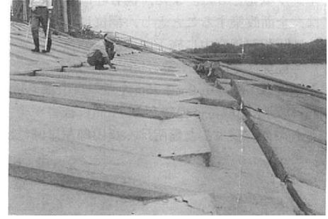
S53年宮城県沖地震による護岸の被災状況 【宮城県岩沼市】
