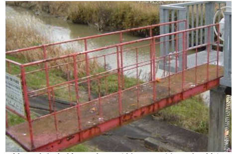
管理橋塗装の劣化(笹原川第6樋管)
