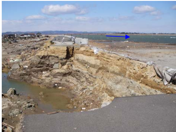
津波によって被災した河口部の堤防（宮城県亶理町）
