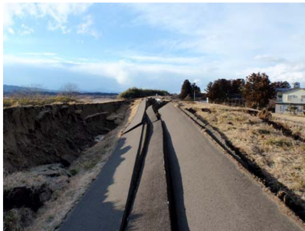
地震によって崩落した堤防（宮城県角田市）
